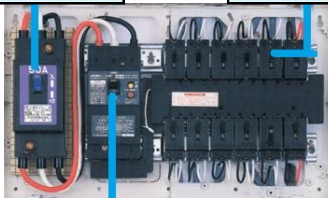
漏電用ブレーカー
